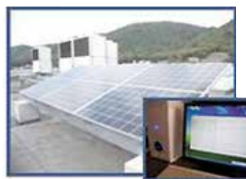
太陽光発電システムの発電電力予測 Prediction of power generated in photovoltaic generation systems
